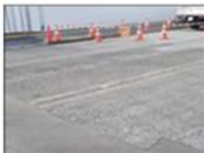
地点5_工事中・路面の凸凹
